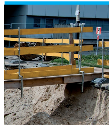
Przejście nad wykopem musi być zabezpieczone balustradami.
